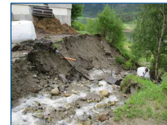
Dégâts causés par l'eau, E6 Birri-Otta - Norvège
