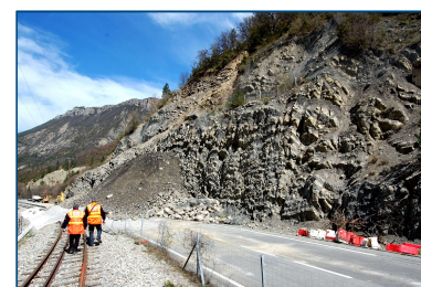
Glissement de terrain, RN85 – France
